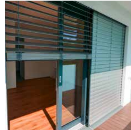
ELEKTRISCHE ROLLLÄDEN/ RAFFSTORES BEI ALLEN FENSTERELEMENTEN
